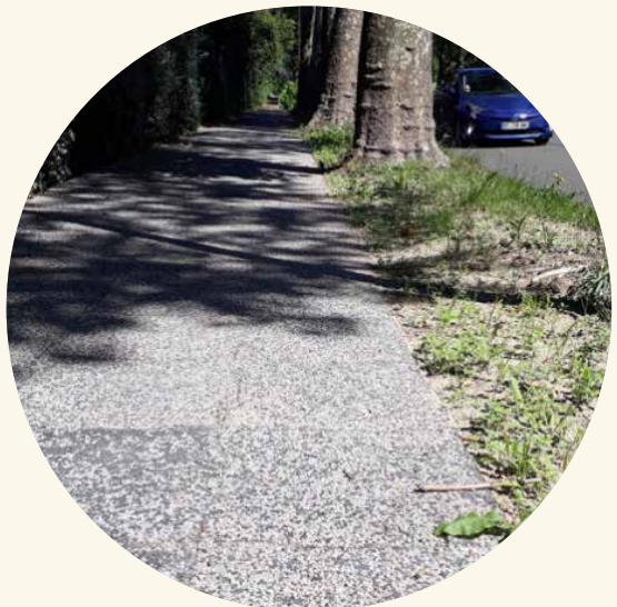
Dalles à base de plastiques recyclés : Eurovia. Revêtement perméable produit grâce à l'équivalent de 400 à 500 emballages plastiques
